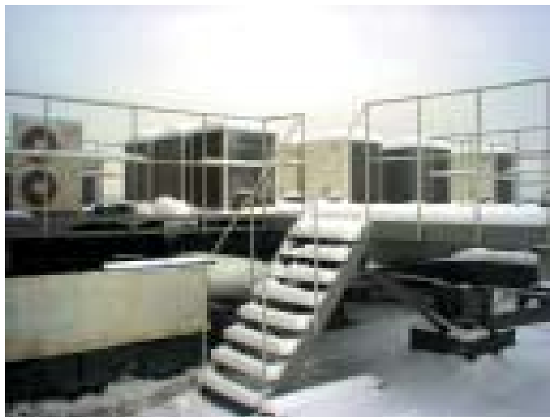
Фото 3. Специальная платформа на крыше здания
