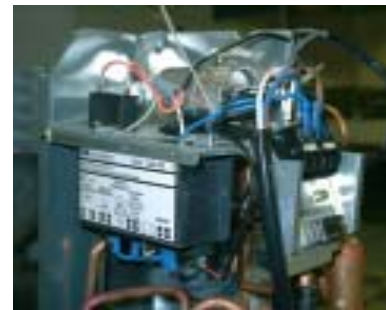
Фото 6. Так выглядит полностью смонтированный регулятор
