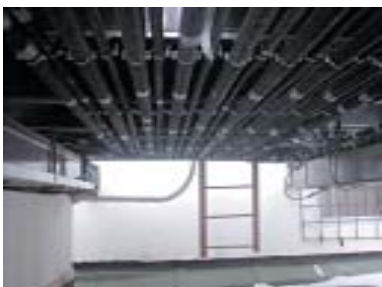
Фото 4. Коммуникации на крыше здания
